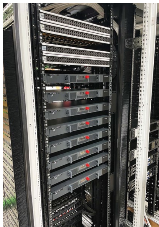
Installationsinfrastruktur auf der „Star of the Seas“ (Foto: Riedel)
