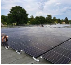
Photovoltaik-Anlage auf dem Firmendach (Foto: LMP)
